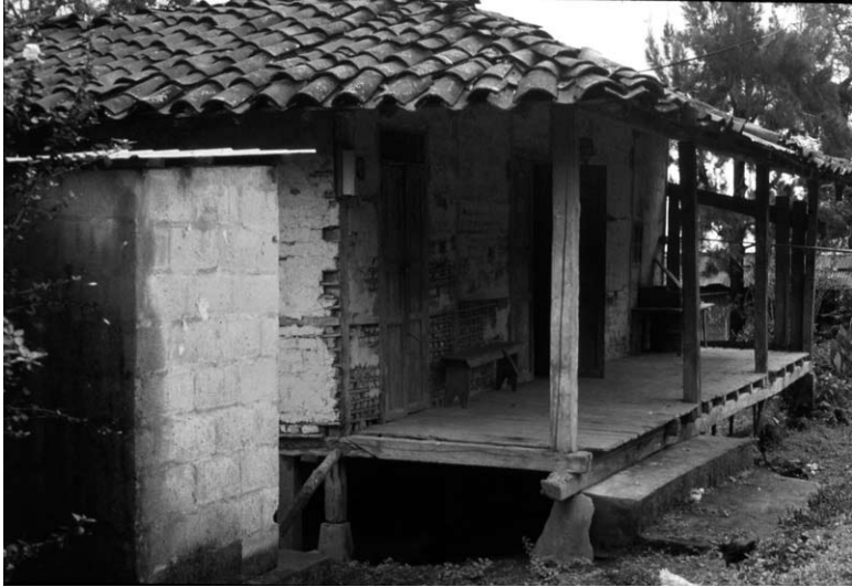
Foto 125. Paredes de bahareque y techo de teja, típica arquitectura popular rural. Morales - Portovelo.
