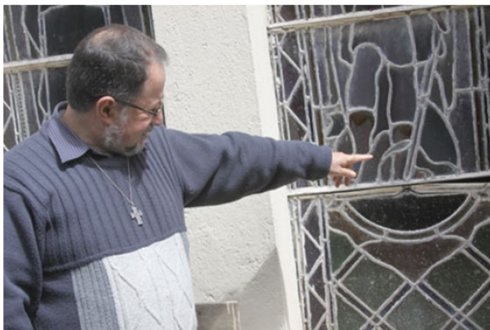
El padre Rafael Nieto muestra los daños en los vitrales, estando afectados principalmente los del lado derecho de la iglesia de San Alfonso.
